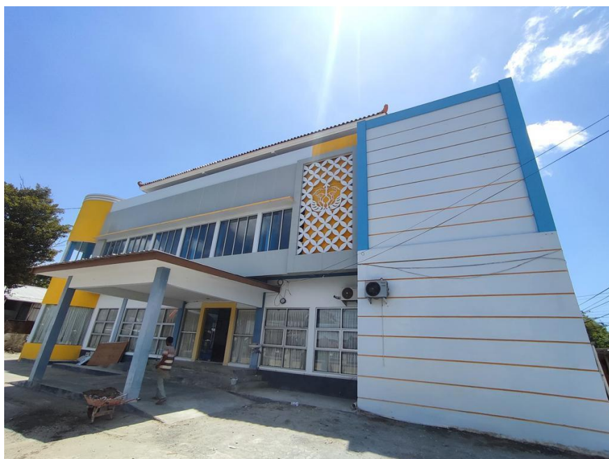
Gambar 3. Pembangunan Gedung Metrologi pada Dinas Koperasi UKM Perindustrian dan Perdagangan Kabupaten Bantul
